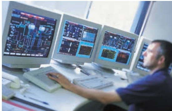
Von der zentralen Leitwarte aus werden sämtliche Prozesse im Kraftwerk gesteuert
